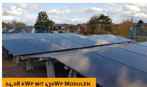
24,08 kWp MIT 430Wp MODULEN
